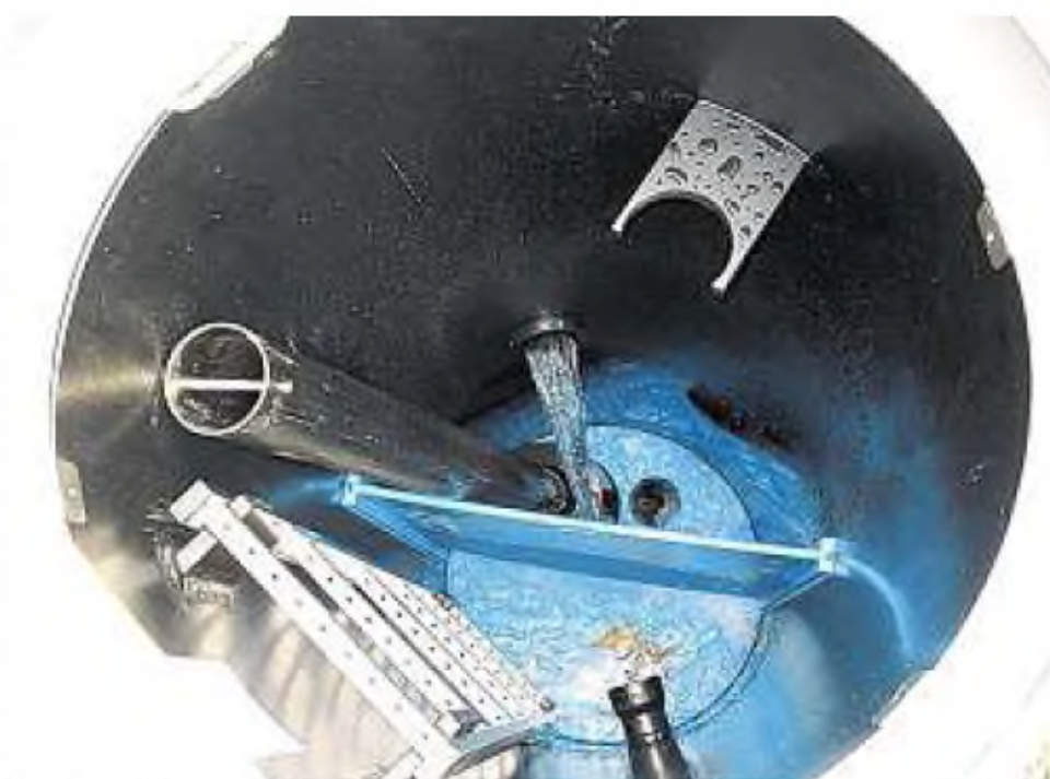
Moderne Anlage: In solchen Quellschächten wird das Wasser auf dem Hüsliberg gesammelt.
